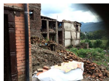
いかに鉄筋が入っていないかがよくわかる
