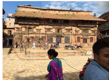
伝統的レンガ組都市住宅、かなり損傷しており、倒壊防止のつかえ柱がかけられている
