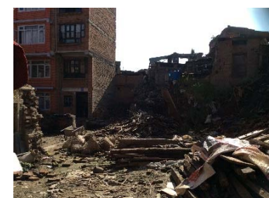
完全に崩壊した場所に隣接して半壊したところがモザイク的に広がっている。古い建物は完全崩壊、最近建ったものは半壊で残っている所もある。
