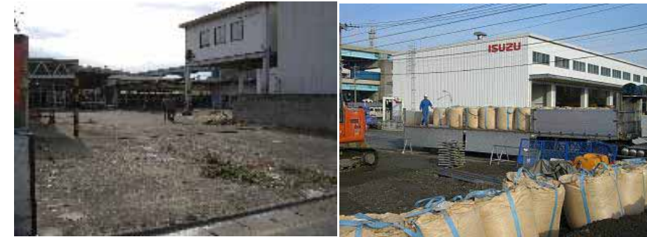
鉛汚染土壌(マンション建設地)福岡
